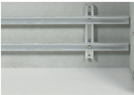
Feuchtigkeitssperre mit Kabelzugentlastung
